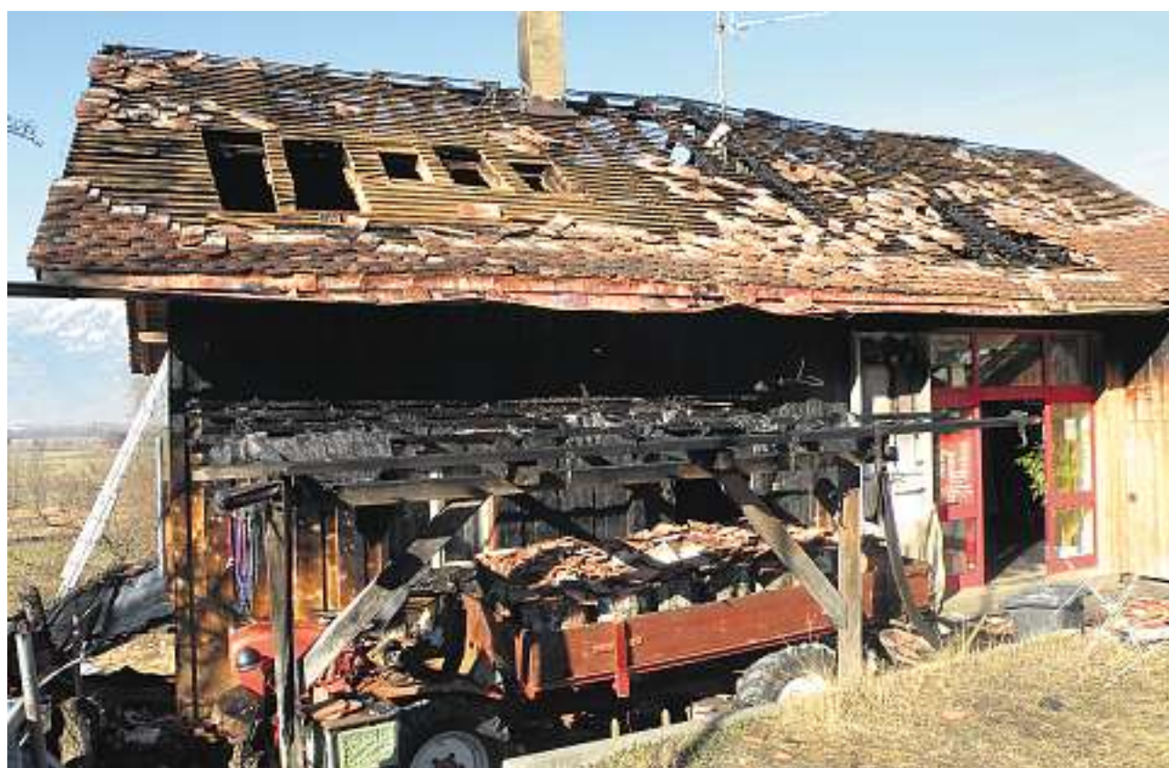
Blick von der Churerstrasse auf das zerstörte Haus: Hinter der verkohlten Wand ist das Wohnzimmer.
