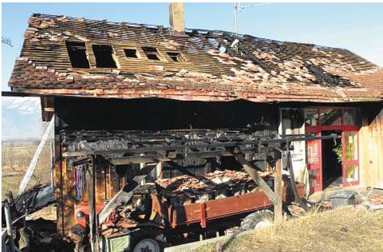
Blick von der Churerstrasse auf das zerstörte Haus: Hinter der verkohlten Wand ist das Wohnzimmer.
