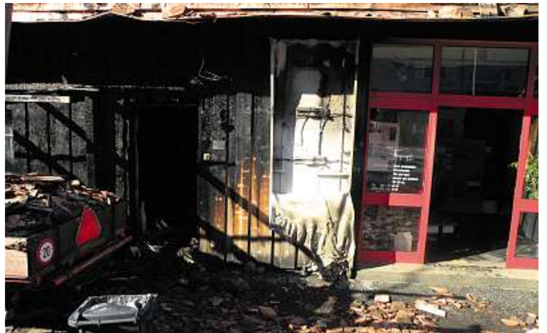
Deutliche Spuren erkennbar: Links hinter dem Anhänger ist der Eingangsbereich ins Haus. Die Aussenwand ist verkohlt. Rechts hinter der Tür befindet sich das Treppenhaus.
