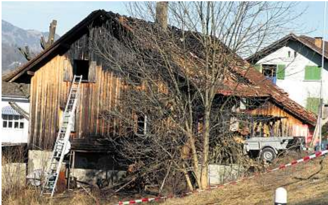
Die Südansicht: Der obere Bereich ist verkohlt, weil sich das Feuer vom Untergeschoss durch das Treppenhaus, das wie ein Kamin wirkte, verbreitete.
