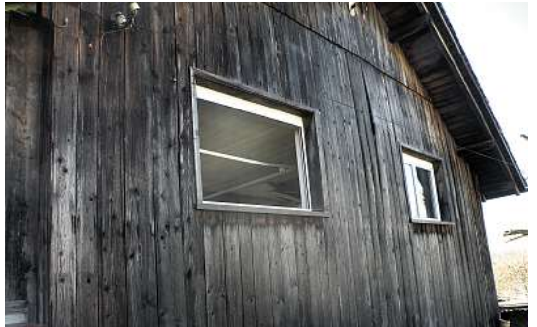
Die Nordansicht: Obwohl man am Dienstag Flammen im Dachstuhl erkennen konnte, ist dieser Teil des Hauses mehrheitlich verschont geblieben.
