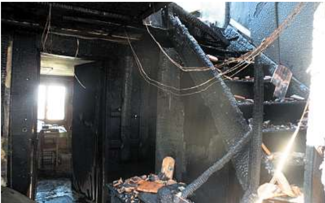
Das Treppenhaus und die Küche im Hintergrund: Unter dieser Treppe befindet sich der Zugang zum Untergeschoss, wo das Feuer ausbrach.
